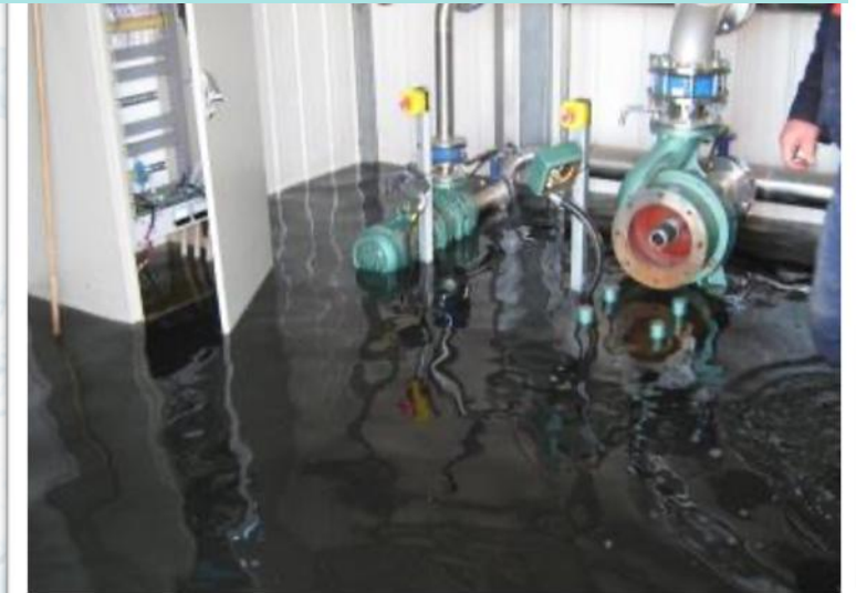
Daños a bienes e infraestructura.
