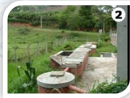
Descarga de efluente tratado
